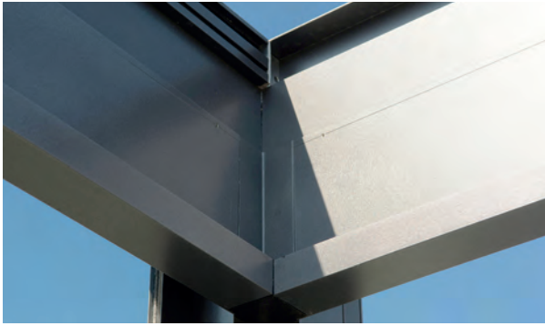
Wasserablauf in der Stütze
